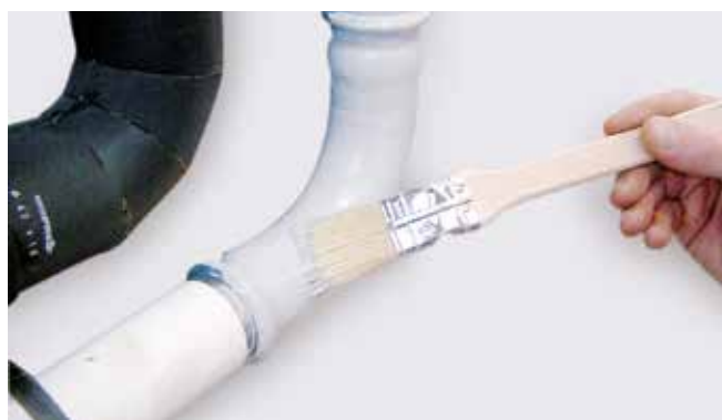
Bilde 34 – Grunn koblinger og rør.
